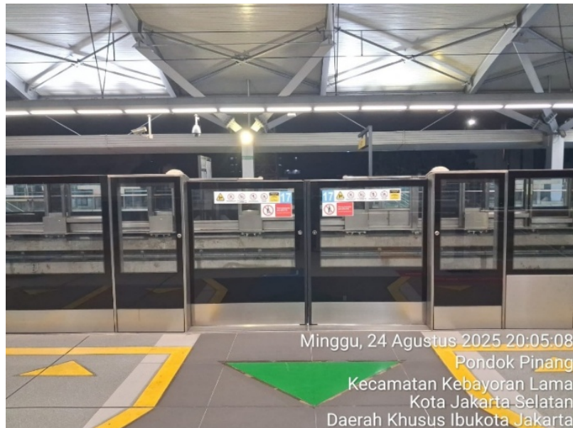
Gambar 3. Platform screen door di Stasiun Lebak Bulus Sumber: (Dokumentasi penulis, 2025)
